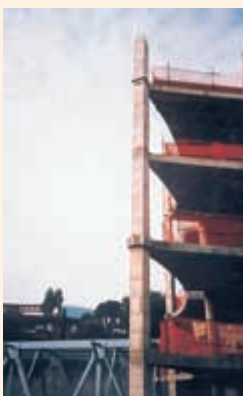
Foto 6. Nudos excesivamente débiles en un edificio de hormigón armado con forjados reticulares. Sus pilares están girados bajo un ángulo de 45º respecto a la dirección según la cual se espera el mayor desplazamiento horizontal durante un terremoto. La conexión pilar-forjado que puede verse es sumamente débil lo que reduce aún más la ductilidad estructural.
