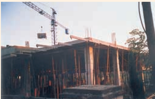
Foto 5. Edificio con el pilar de esquinas insuficientemente armado para resistir acciones sismicas. Obsérvese que los pilares centrales tienen más armadura, lo que demuestra que la estructura ha sido dimensionada sólo a acciones verticales y estáticas.
