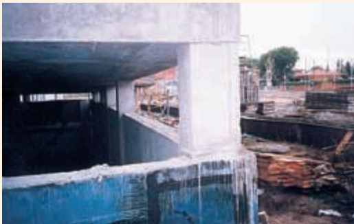
Foto 4. Edificio de hormigón armado con pilares cortos en su base. La mayor rigidez de éstos implica un incremento del esfuerzo cortante que puede producir un fallo frágil de la estructura.
